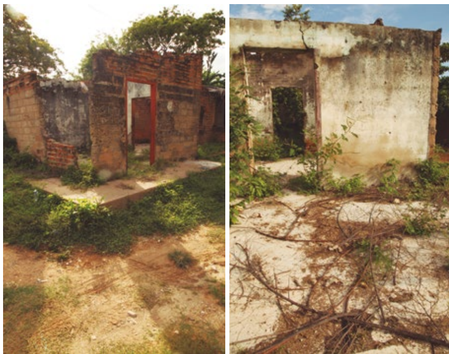
CASAS ABANDONADAS Y DESTRUIDAS. CORREGIMIENTO DE AGUAS BLANCAS, MUNICIPIO DE VALLEDUPAR, CESAR, 2014. FOTOGRAFÍAS: PABLO NICOLÁS BURGOS PARA EL CNMH.
