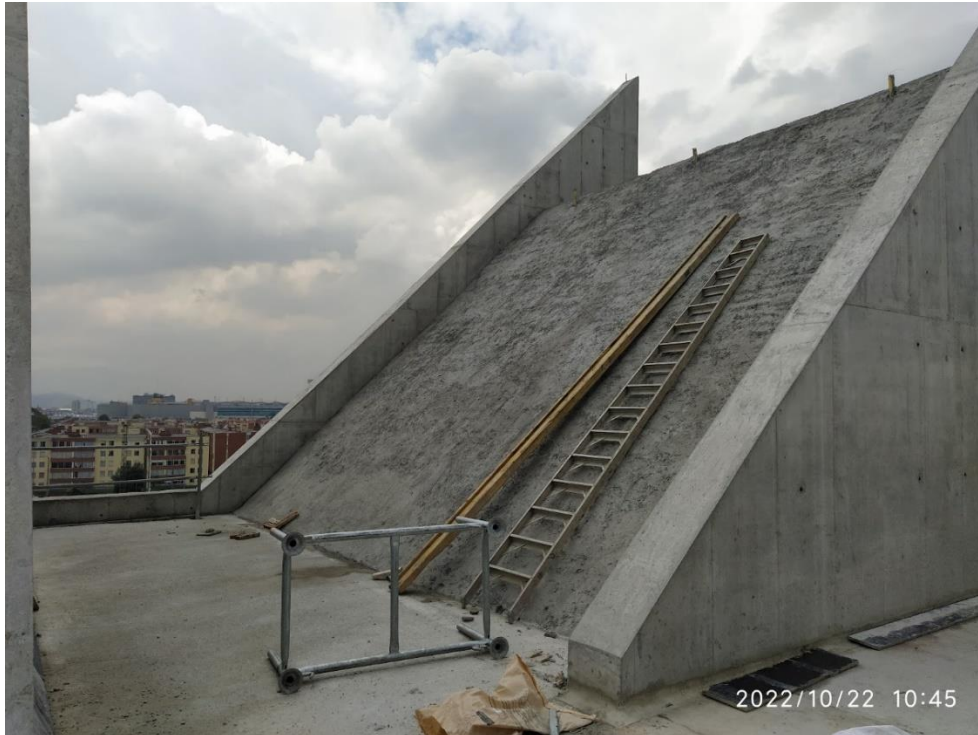
Avance presentado del armado de acero, formaleta y vaciado de concreto para placas inclinadas de los picos de cubierta.
