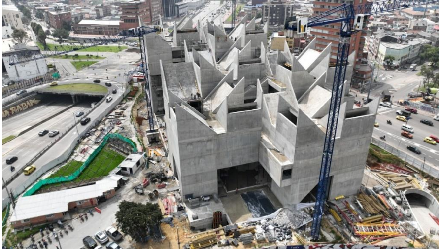
Perspectiva estado general de la construcción y picos pertenecientes a cubierta. Fuente: Pacheco Estudio de Arquitectura.
