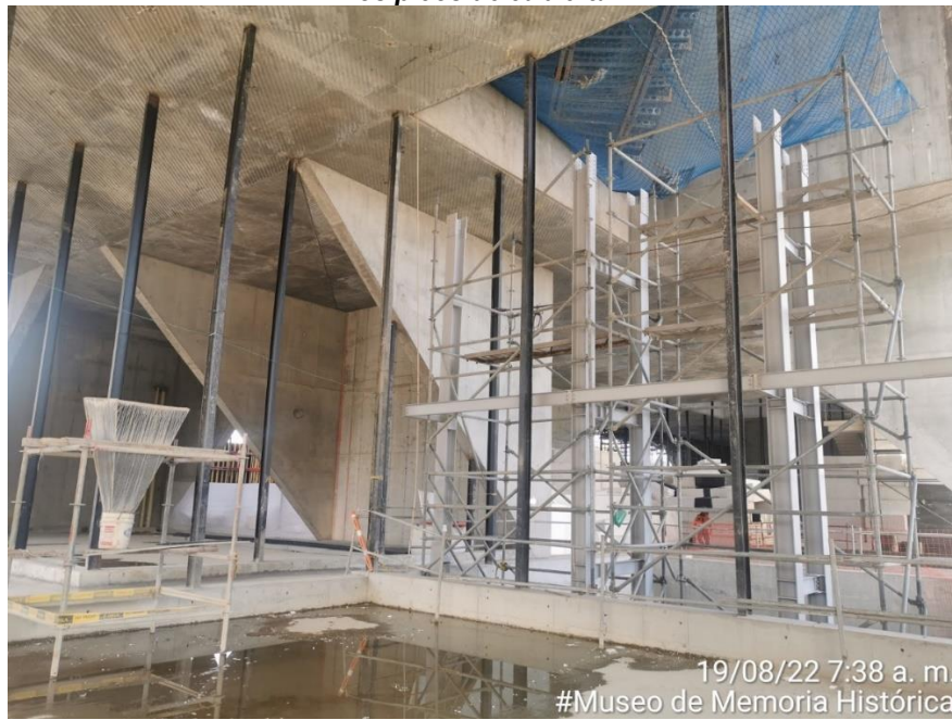
Instalación de estructura metálica núcleo oriental de ascensores y perfiles IPE 180 para cerramiento en policarbonato.
