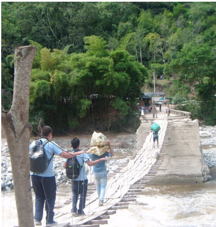
Puente Cambrín, colapsado por el invierno. Los pobladores debían hacer transbordo. Fotografía para el CNMH del archivo fotográfico de la Corporación Casa Teatro Antonio Camacho, 2017.
